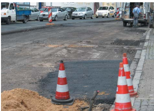
Frostschäden werden bei großen Sanierungen zum Teil mit angepackt
