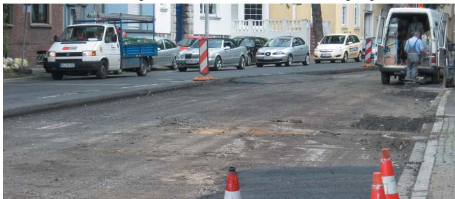
Straßensanierung muss auch in Zukunft möglich sein
